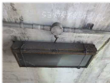
照明設備の腐食
