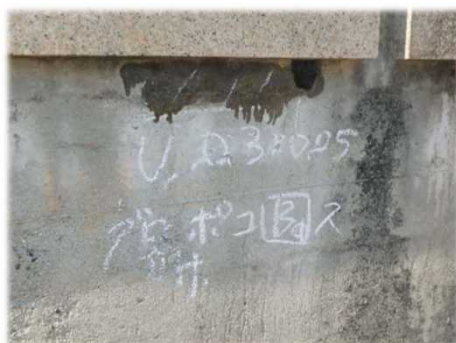
トンネル入口部のうき
