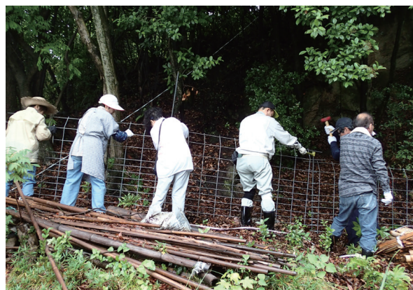
イノシシ侵入防止柵
