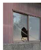
窓が割れた 管理不全空家
