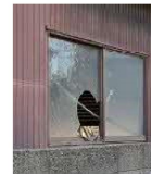
窓が割れた管理不全空家
