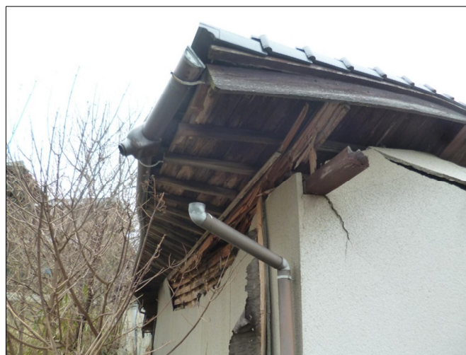
建築物の外壁や屋根の腐朽・破損・欠落の例
