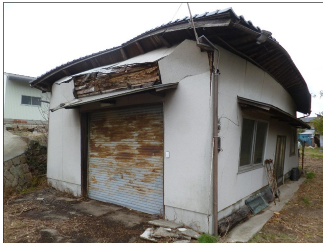
建築物の崩壊、外壁の破損・欠落の例
