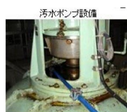
ポンプ本体(内部軸受)の劣化
