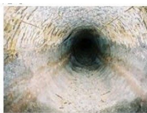
硫化水素による管路の腐食
