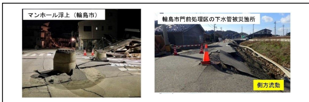
写真 R6能登半島地震による下水道施設の被害（出典：国土交通省HP）
