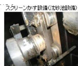
スクリーンかす設備(汚砂池設備) 自動除塵機(イトロー)の偏摩耗
