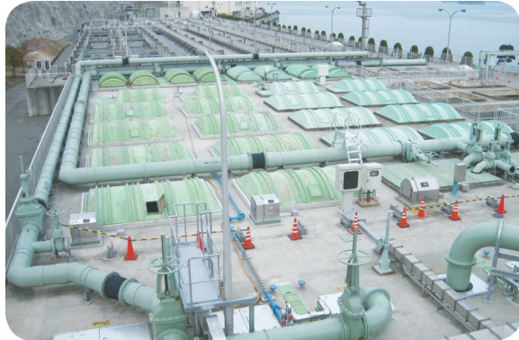
浄化センター
