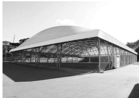
人工芝の整備が望まれる高山ドーム
