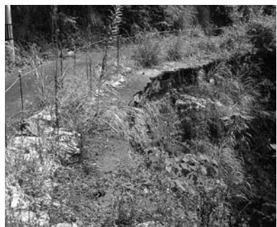
常山登山道崩落箇所
