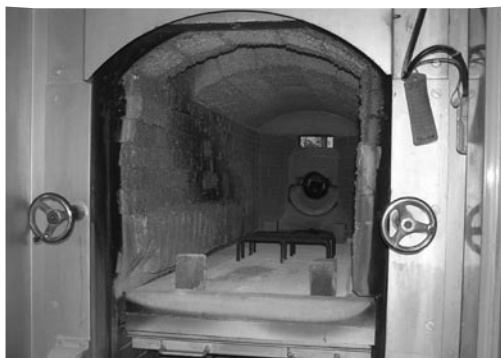
老朽化が懸念される斎場火葬炉
