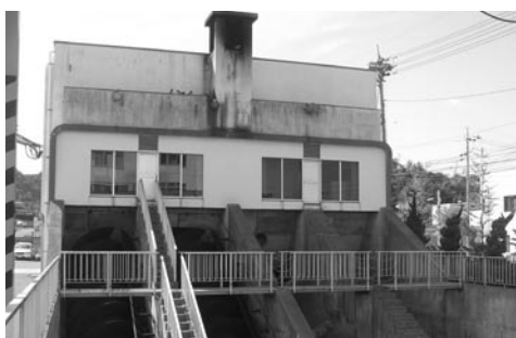
宇野雨水ポンプ場
