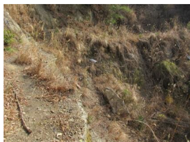
登山道崩落現場
