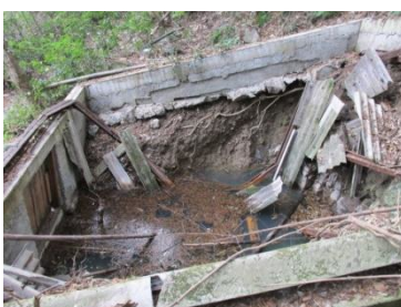
屋根が壊れた底無井戸
